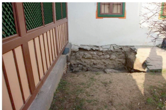
Рис. 3. Шурф 1. Фрагмент фундамента в осях Г/12 имеет дефекты и повреждения
