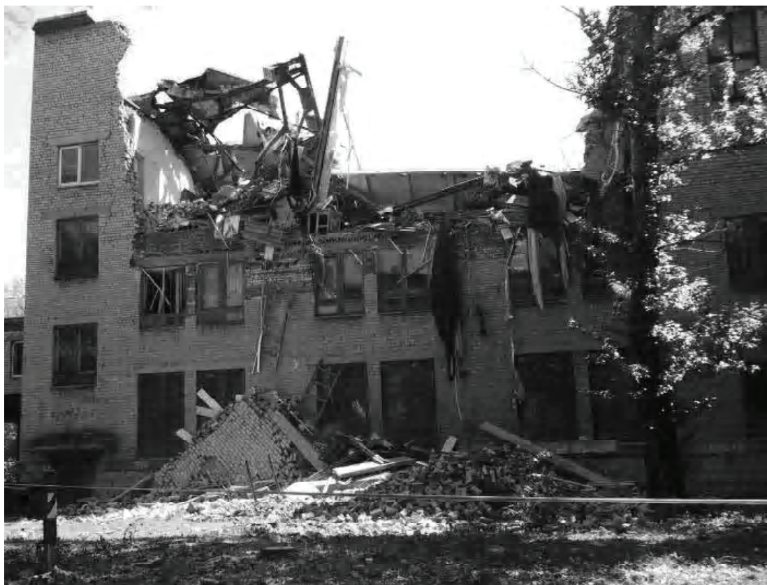
Рисунок 1 – Общий вид участка обрушения строительных конструкций восточного крыла здания учебного корпуса № 4 ДонНУЭТ.
