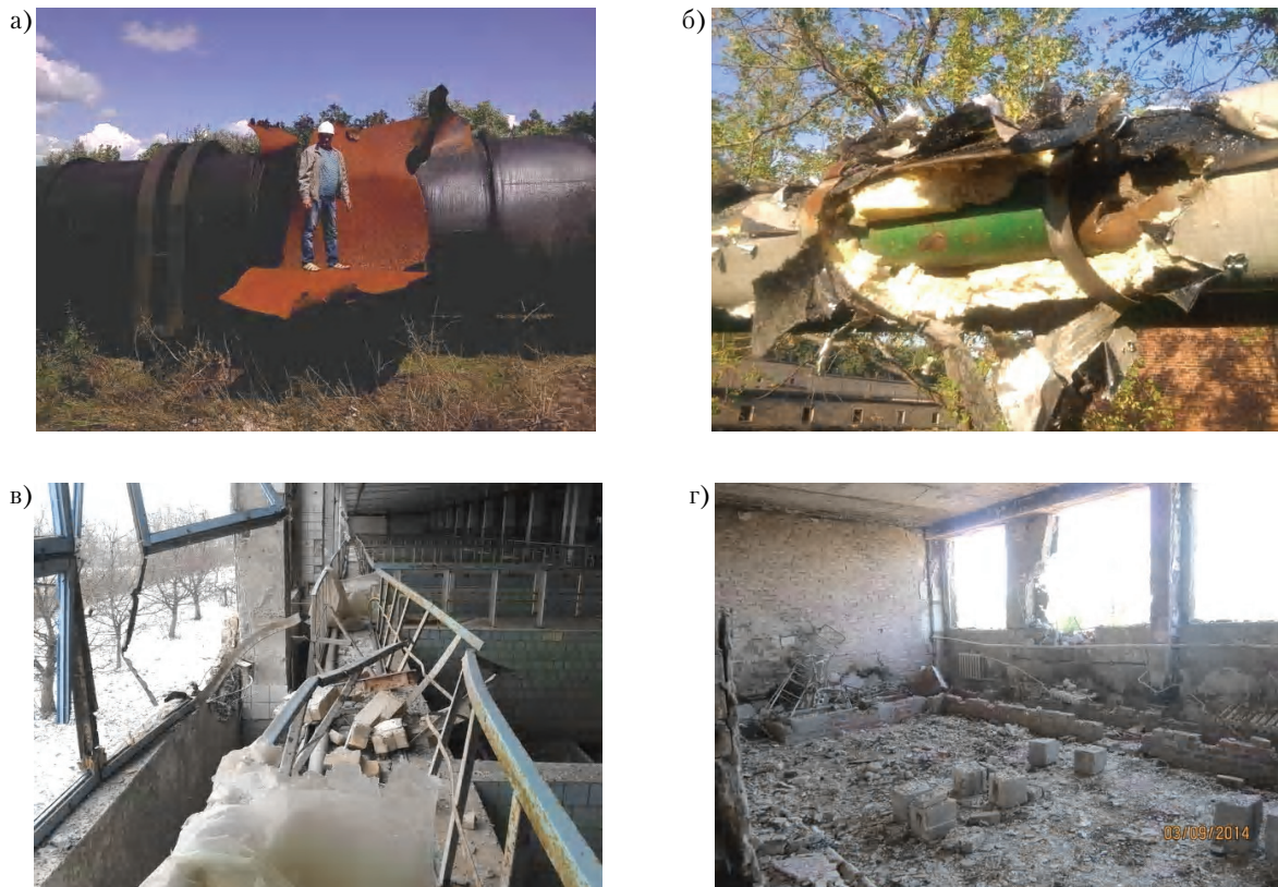
Рисунок 3 – Последствия обстрелов объектов системы водоснабжения: а) поврежденный напорный трубопровод канала Северский Донец – Донбасс диаметром 2 500 мм; б) поврежденный хлоропровод; в) разрушения в здании фильтров Донецкой фильтровальной станции; г) разрушения в лаборатории Донецкой фильтровальной станции.
